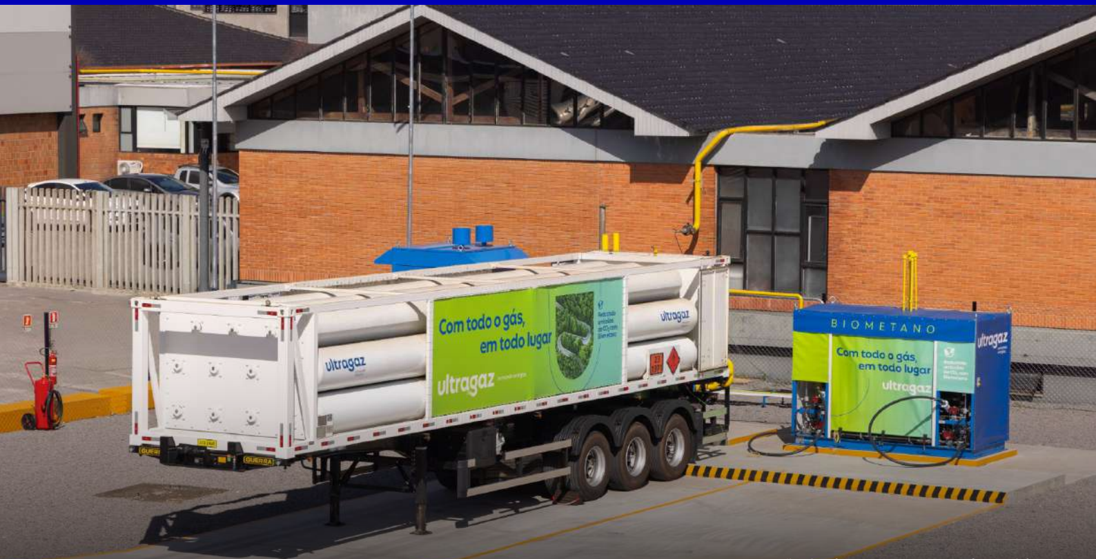
Estação de Biometano - Tramontina Multi
