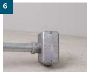
6 Conduit and connector with the joint sealing prepared to realize the ip54 connection on the multiple box correspondent. Electroducto y conector con las juntas de vedaciones preparadas para realizar la conexión IP54 en la caja múltiple correspondiente.
