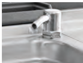
Grifo acoplado para el abastecimiento de agua.
