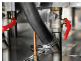
Sistema de drenaje conectado directamente al alcantarillado.
