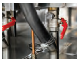
Sistema de escoamento conectado diretamente ao esgoto.
